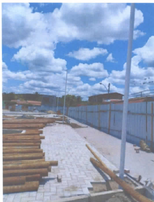
FOTO 10 - POSTE DE ILUMINAÇÃO
