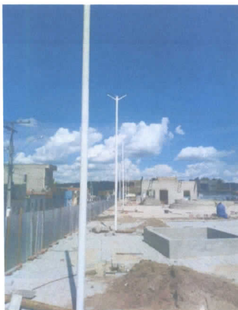
FOTO 18 – POSTE DE ILUMINAÇÃO 2
